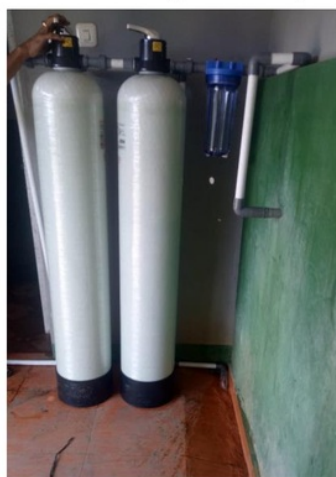
Gambar 3. Alat filtrasi yang dipasang di tempat wudhu
